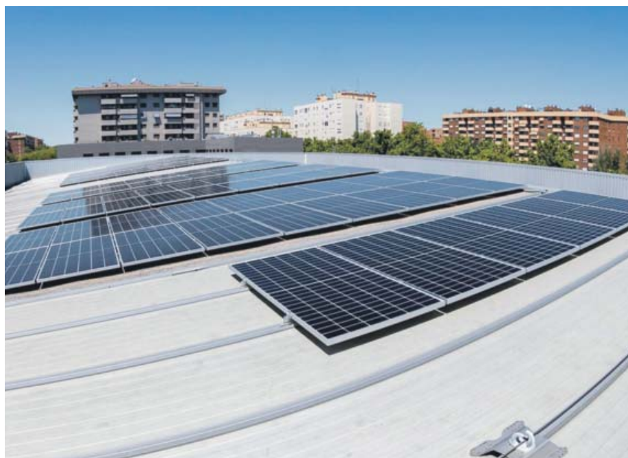
Las placas solares cada vez están más presentes en los edificios de nueva construcción.
