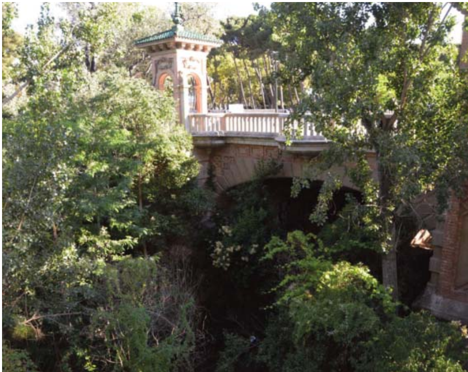
Los ojos del puente de entrada al Parque Grande presentan una situación deplorable.
