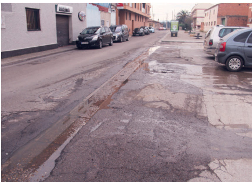
Las deficiencias de la pavimentación de la calle La Sagrada son muy evidentes.
