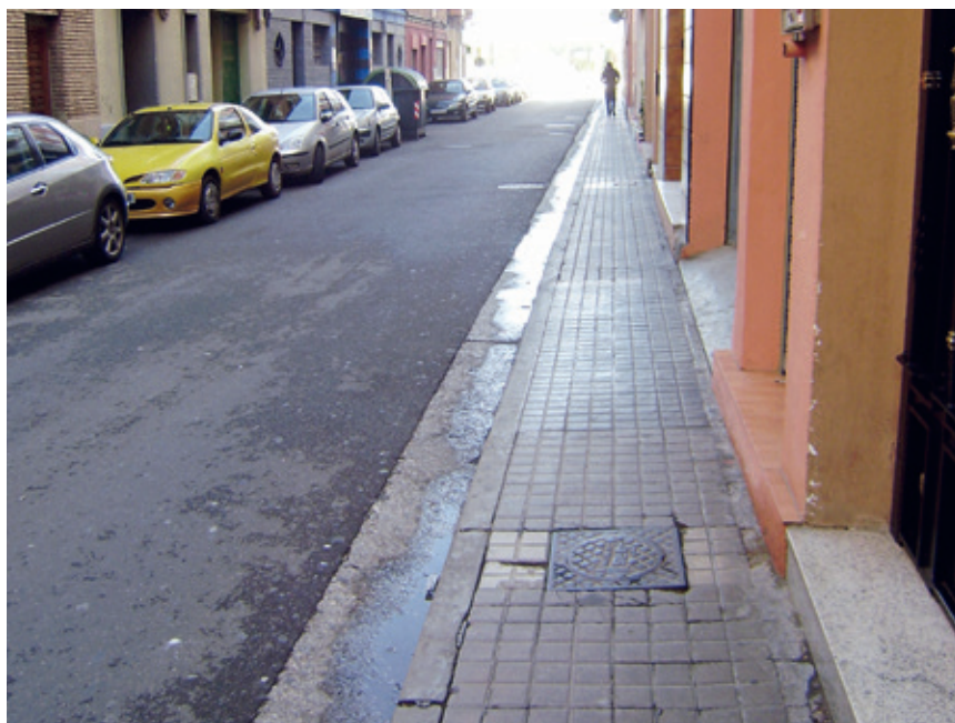
La acera de la calle Escuelas es estrecha y está estropeada.
