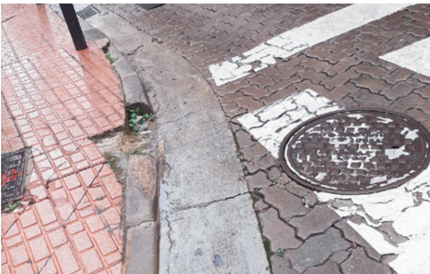
Aceras estrechas y bordillos deteriorados en la calle Hermanos Ibarra.
