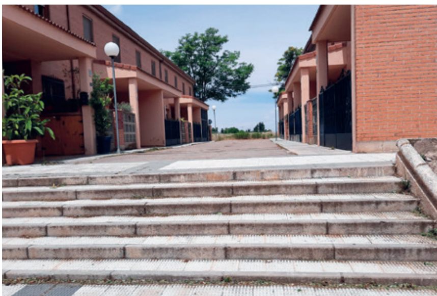
En estas escaleras de la calle Catorce de Septiembre los vecinos piden la instalación de pasamanos.
