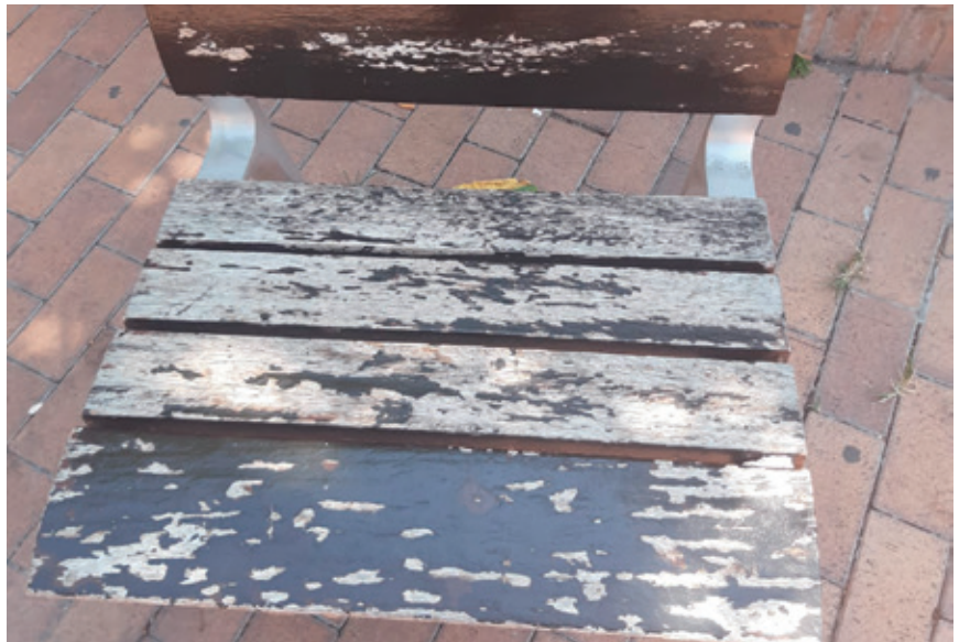
Los vecinos denuncian el deterioro de los bancos en la plaza del Portillo.
