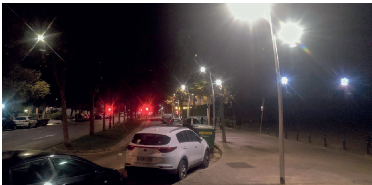
Las nuevas iluminarias son más bajas y no se ven afectadas por la presencia de árboles de gran porte.
