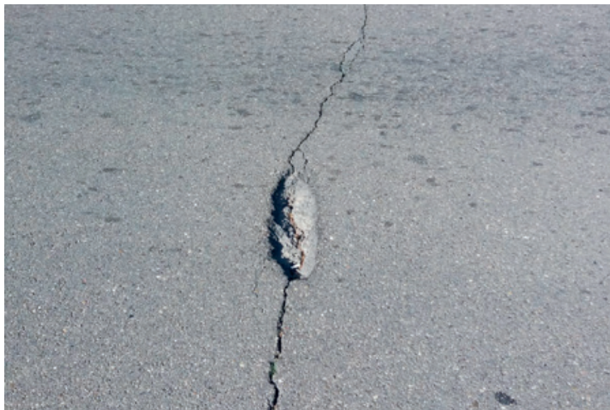
Pavimento en mal estado en la calle Sagrada Familia.
