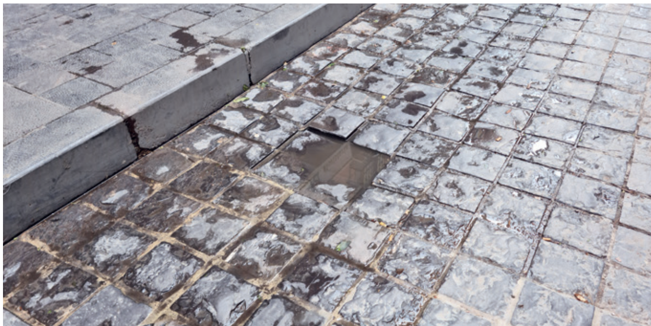
Situación deficiente del adoquinado en la calle Manifestación.
